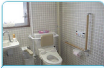
新設された車いすトイレ
